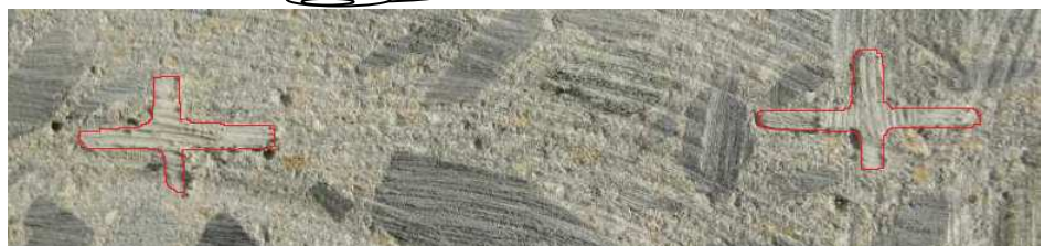
コンクリートを打設した星型スペーサ（プラ・スターG）の切断面
